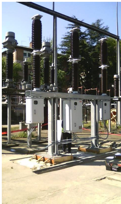
SLIKA 6 – MONTIRAN 110 KV SF6 PREKIDAČ
