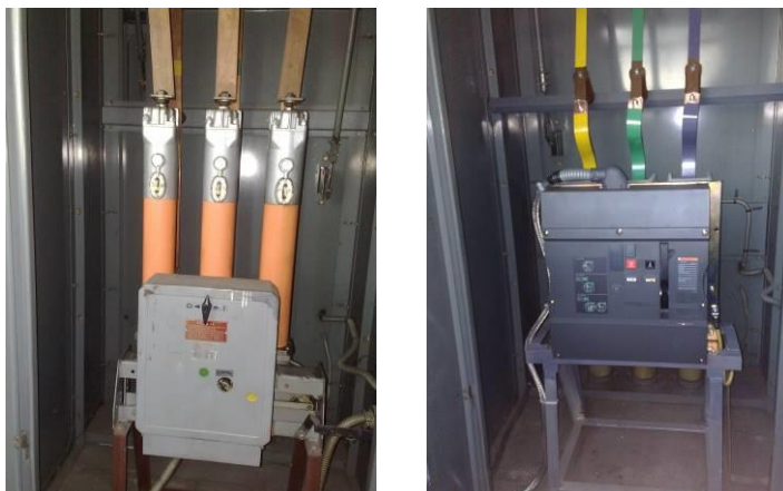
SLIKA 3 – 10 KV MALOULJNI I VAKUUMSKI PREKIDAČ U TS 35/10 KV/KV VI MUŠKA
